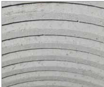
Topné spirály v drážkách zárobetonových tvarovek / Heating coils deposited in refractory castable shapes / Нагревательные спирали в углублениях жаростойкого бетона
